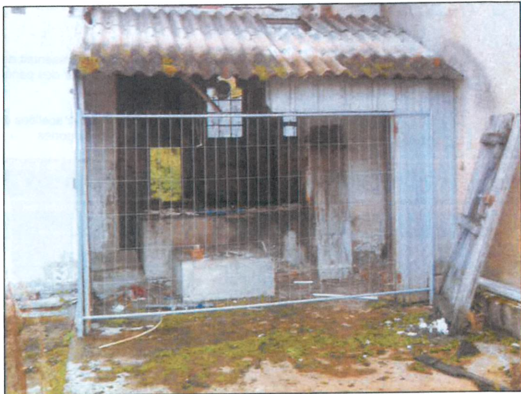
Figure 6 : Barriere sur apprentis
